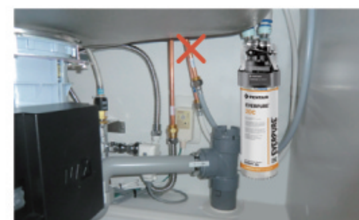
湯水混合水栓への一本化
