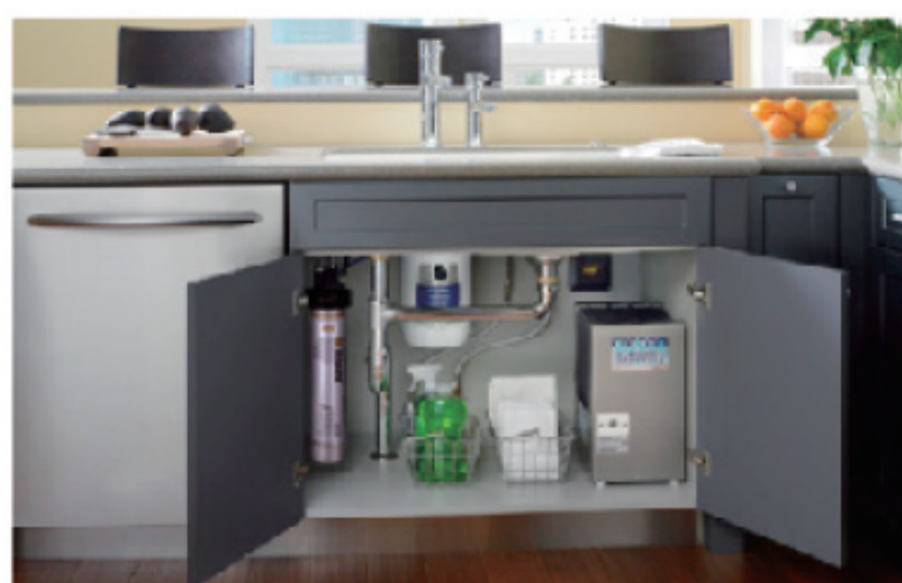
浄水器本体はシンク下に設置
